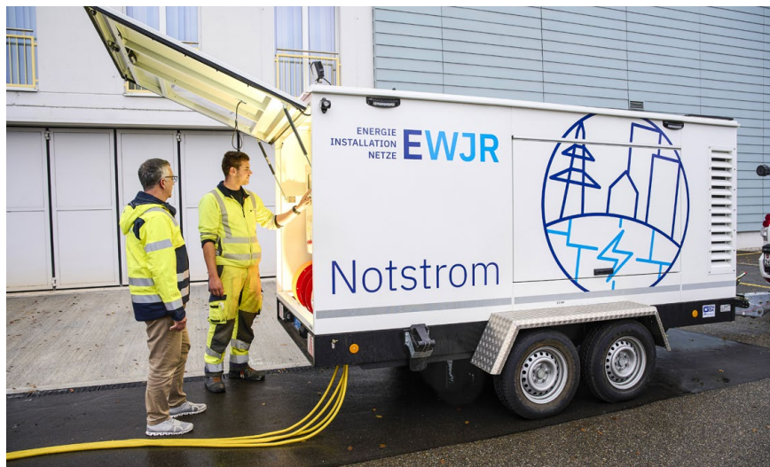
Mobile Notstromaggregate sind unter anderem dafür da, bei längeren Stromunterbrüchen kritische Infrastruktur mit Strom zu versorgen.
