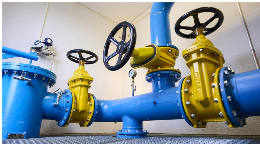
In Rapperswil-Jona spielt Gas eine wichtige Rolle für die Wärmeversorgung.
