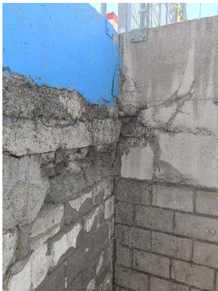
Schadstellen an der Betonstruktur
