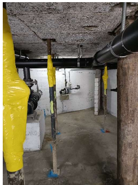
Notspriessung im UG / zersetzte Bewehrung und Betonabplatzungen
