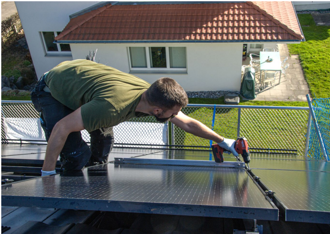
Mit einer Photovoltaik-Anlage können Hausbesitzer ihren eigenen Strom produzieren. (Foto: Zürichsee-Linth)
