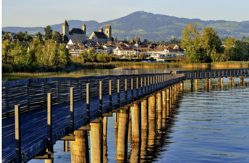
Der Holzsteg ruht auf 239 Eichenpfählen. An ihnen nagt inzwischen ein Pilz namens Eichenwirrling. (Foto: Archiv, RZST)
