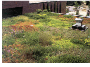
Extensive Dachbegrünung anstelle Kiesdächer
